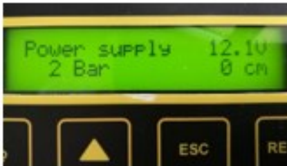
Aktuelle Stromversorgung, Druck, Tiefe
